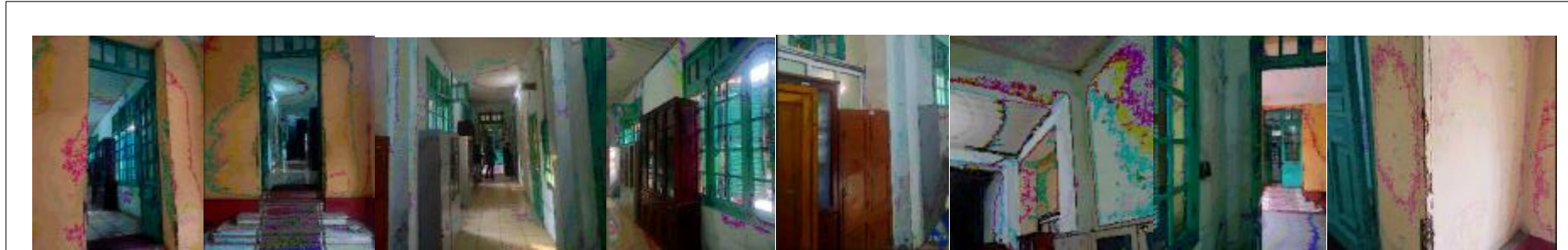
HÀNH LANG 01:TƯỜNG NỨT VỠ, ẨM MỐC, PHÒNG RỘP, BONG TRóc SƠN. TRẦN NHỰA MỤC VỠ, CẦU THANG ĐÃ HỒNG MỤC GẦY, KHÔNG SỬ DỤNG ĐƯỢC. NẾP CẠNH TƯỜNG BỊ LỘ THÉP
