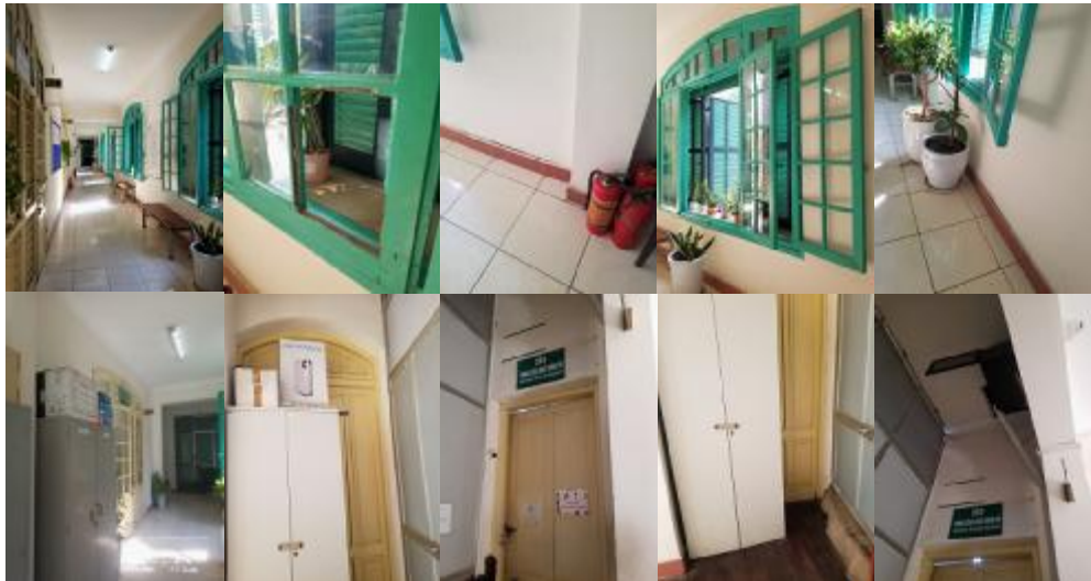
HÀNH LANG: - XUẤT HIỆN BONG NÚT GẠCH ỐP CHÂN TƯỜNG - CỬA SỐ MỘT SỐ BUNG NẾP, MỘT SỐ CỬA MẮT, VỠ KÍNH - NIẾN GẠCH MỘT SỐ CHỖ BONG, VỠ
