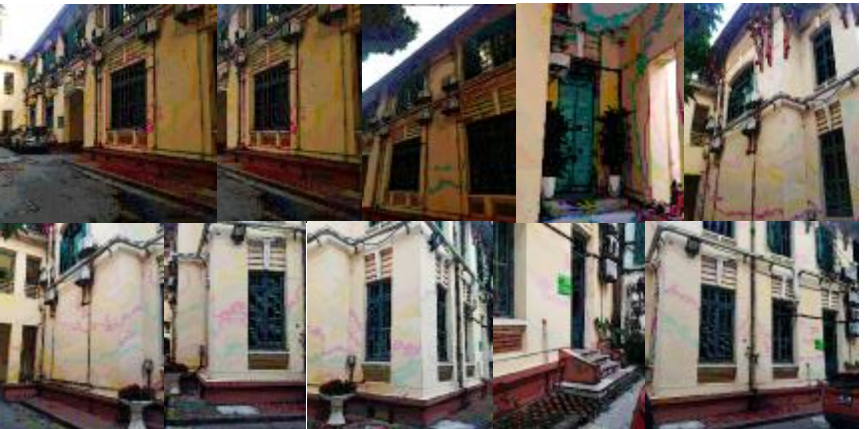
HIỆN TRẠNG MẶT TIỀN PHÍA SAU: TƯỜNG NÚT VỠ, ẨM MỐC, PHÒNG RỘP, BONG TRÓC SƠN. CỬA SỔ BỊ MỤC, TRÓC SƠN, VÔNG CÁCH. SƠN TƯỜNG HAI TẦNG BỊ LỆCH MÀU. MÁI NHÀ ĐÃ HƯ HỎNG, HAN RỈ.
