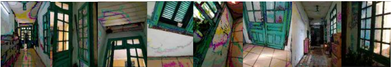
HÀNH LANG 02: CỬA SỔ CỬA ĐI HỒNG KHUÔN, BONG SƠN. TƯỜNG NÚT VỠ, ẨM MỐC, THẤM DỘT TRẦN NHỰA MỤC VỠ, SÀN NHÀ NÚT VỠ KHÔNG BẰNG PHẪNG
